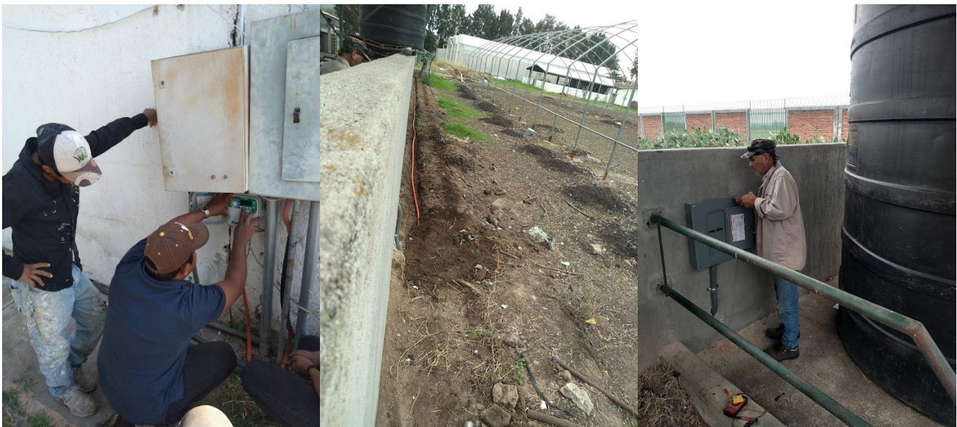
Imagen 18. Instalación eléctrica en zona agrícola.
